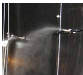
Nebulizador, controle de umidade
